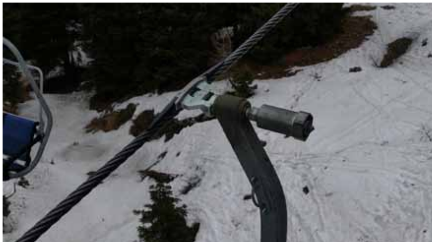
Morsa di un veicolo ad ammassamento permanente
